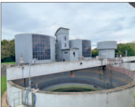
Bild 2: Schlammfaulung – Von Faultürmen und Voreindicker ...
