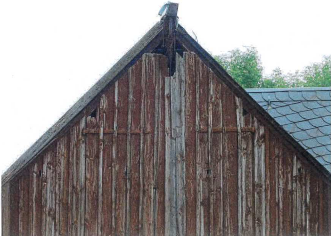
Foto 9: Westseite Scheune Flstk.-Nr. 13/2 mit Fehlstellen im Bereich des Heuaufzugs als potentielle Einflugmöglichkeit für Fledermäuse, Hausrotschwanz, Rauchschnalbe, 14.08.2020.
