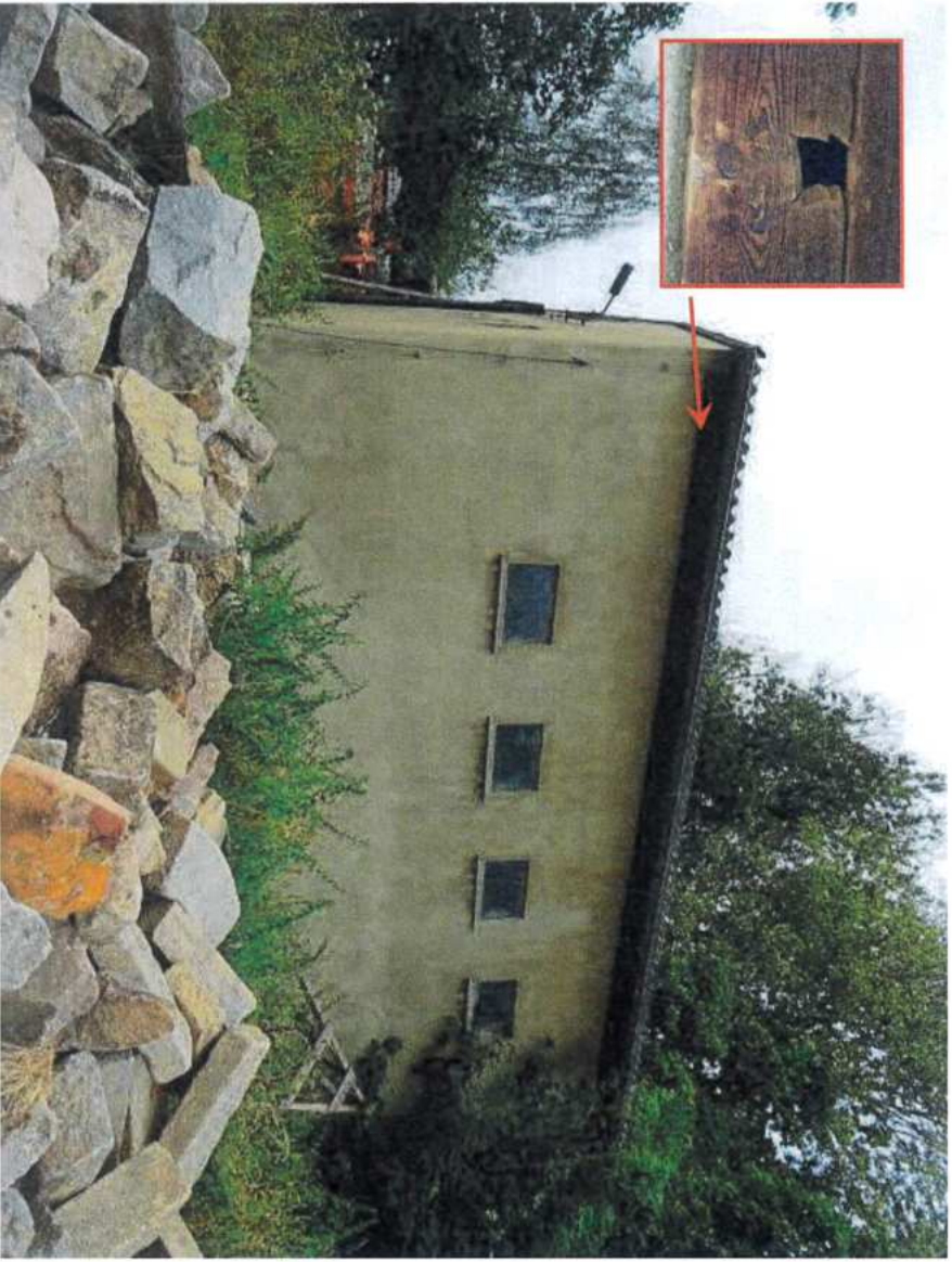
Foto 7. Detailansicht Lagerhalle (Ostseite) mit Öffnung in Dachkasten als potentiellem Quartier gebäudebegleitender Vogel- und Fledermausarten (Ausschnitt), 14.08.2020.
