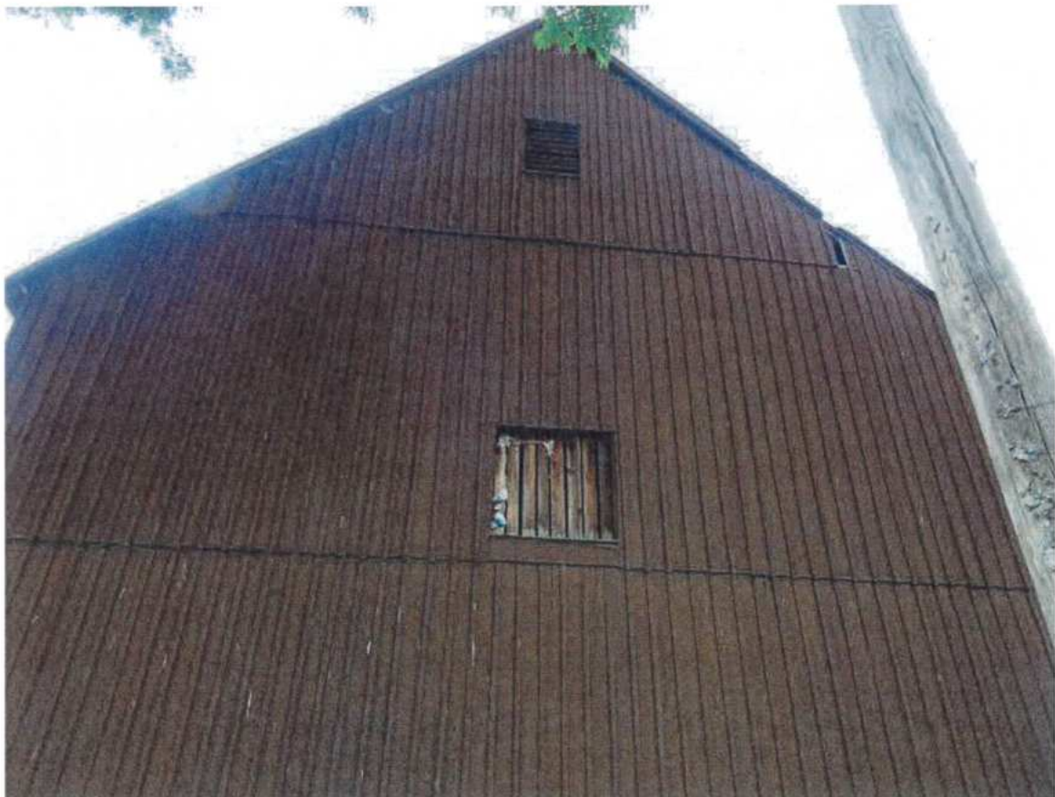
Foto 10: Ostseite Scheune Flstk.-Nr. 13/2 mit Einflugmöglichkeiten für Fledermäuse, Hausrotschwanz, Rauchschnalbe durch Lamellen des Fensters bzw., durch gelöstes Brett, 14.08.2020.
