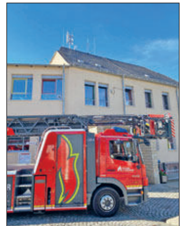
Sirenenerrichtung an der Grundschule Beutha
