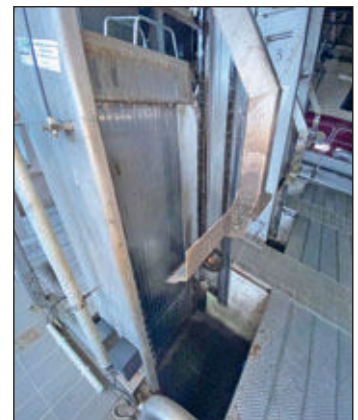
Bild 3: Grobrechen im Rechenhaus (Bild: WAD GmbH)
