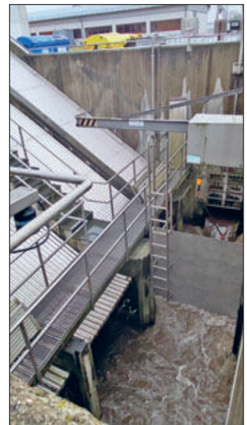
Bild 2: Jede unserer Schnecken schafft es, 560 l/s anzuheben. Der Zulauf bei Trockenwetter beträgt durchschnittlich 17.000 Kubikmeter Abwasser/Tag. Bei Regenwetter verzeichnen wir einen Zulauf von bis zu 1200l/s. Dafür ist unsere Kläranlage auch bei Havariefällen ausgelegt, um eine stabile Abwasserbehandlung zu gewährleisten (Bild: WAD GmbH)
